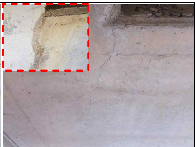
교각 P3(오창방향) 균열(폭 0.3mm)(보수완료)
